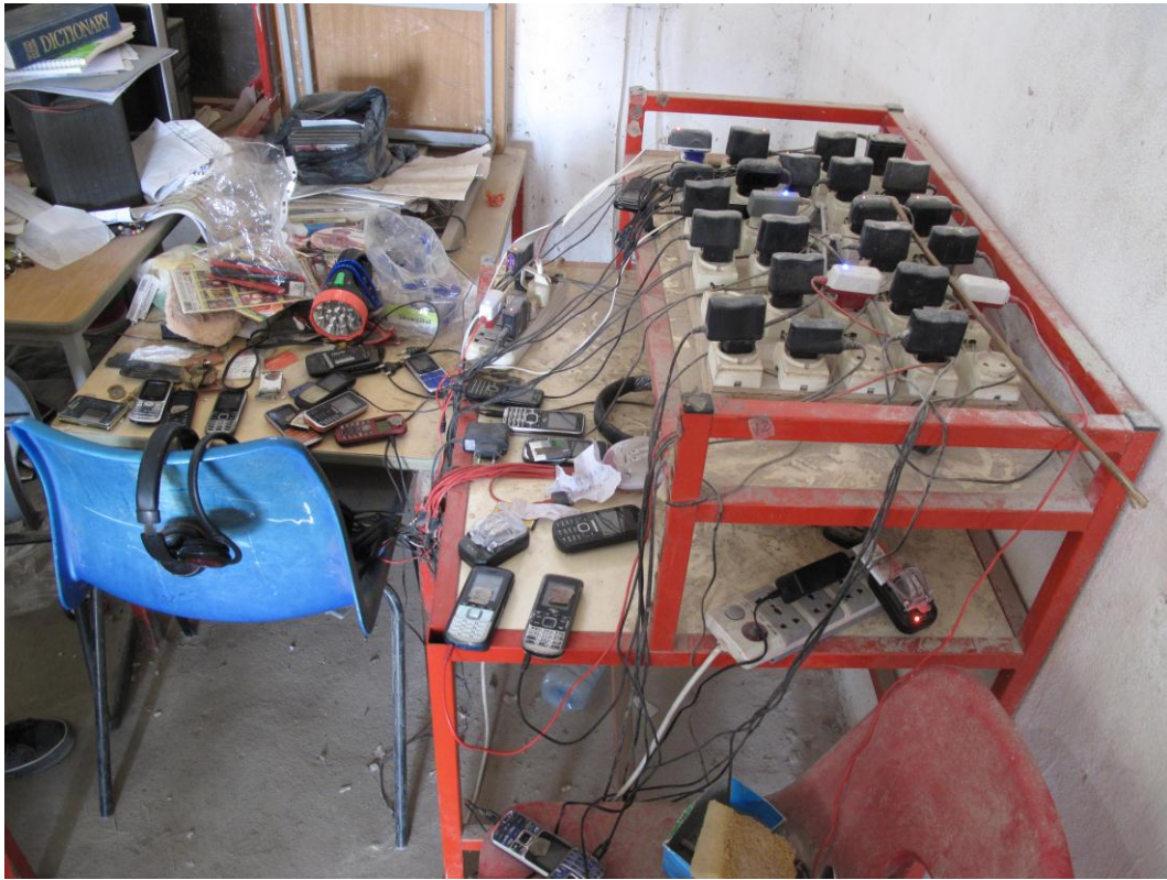
Ladestasjon for om lag 50 mobiltelefonar. Litt rotete grunna ombygging av lokalet.
